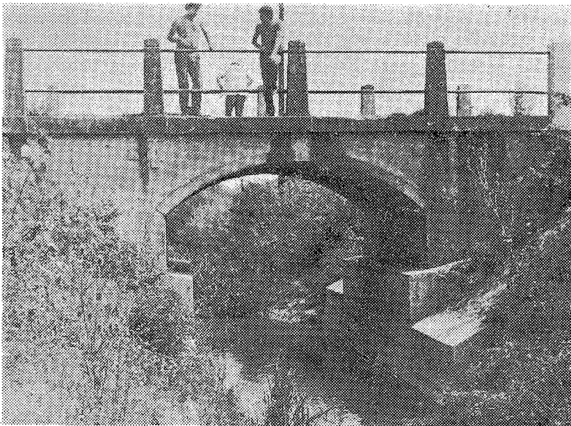
Sl. 9.3. Svođeni propust otvora 300 cm preko vodotoka Vidor na slivnom području Biđ-Bosut«. Dat je prikaz naknadnog podzidavanja temelja upornjaka zbog spuštavanja dna u sklopu rekonstrukcije vodotoka
